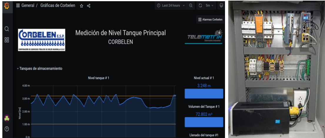
Registro Telemetría de nivel de Tanque Elevado.
