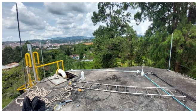
Registro fotográfico sistema apantallamiento Tanque elevado.
